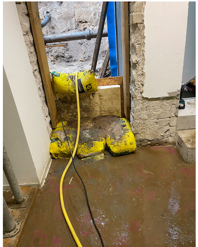
Ausmaß der Überschwemmung nach dem Starkregen im Juli 2021
